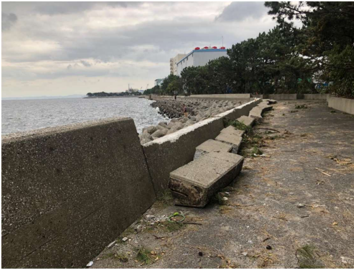
写真1 令和元年房総半島台風の高潮で倒壊した横浜市金沢区沿岸の堤防(宮本ら 2022 より)
