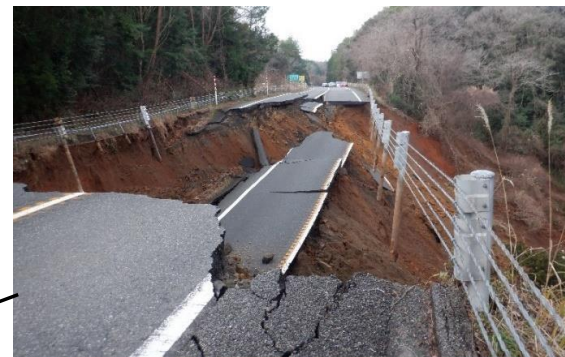
道路崩壊 (のと里山海道)
