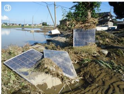
③ 越水地点周辺：太陽光パネルの流出が見られた
