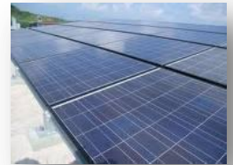
太陽光パネル
